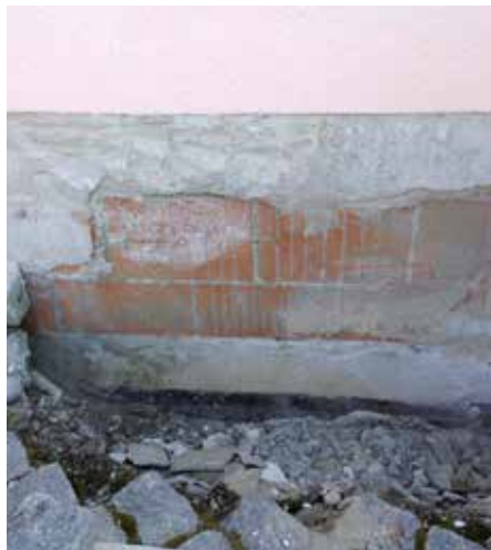
Sockelschaden durch Staunässe
