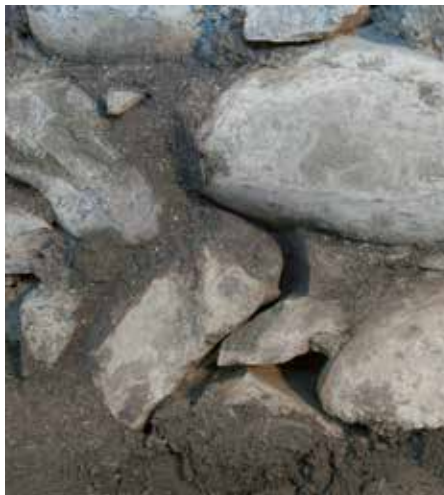
Fehlstellen in Natursteinmauerwerk
