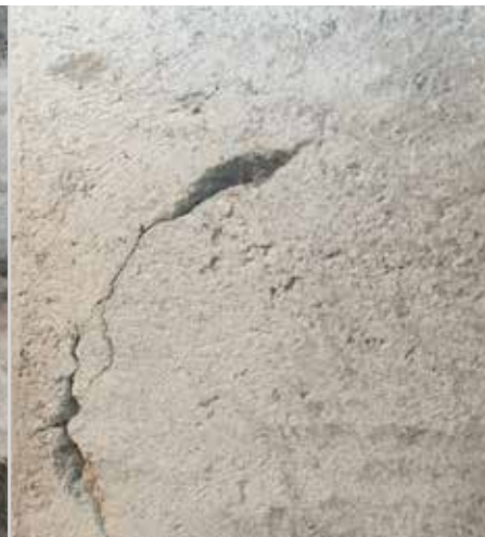
Fehlstellen in Altputz
